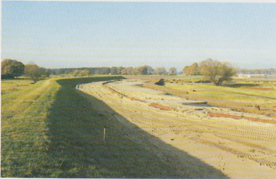
Abbildung 27: Gespülter Deichkern (Sand) unterhalb vom Neubrack in der Gemarkung Pevestorf, Oktober 1985
